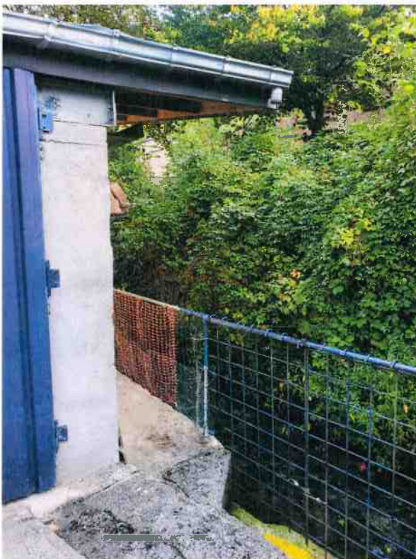
Photo de l'évacuation des eaux pluviales du garage
